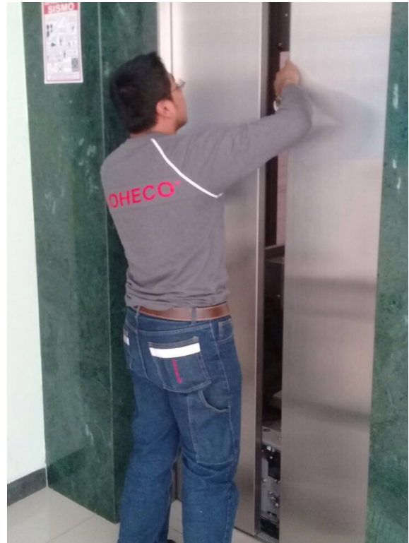
.Mantenimiento de ascensores.
