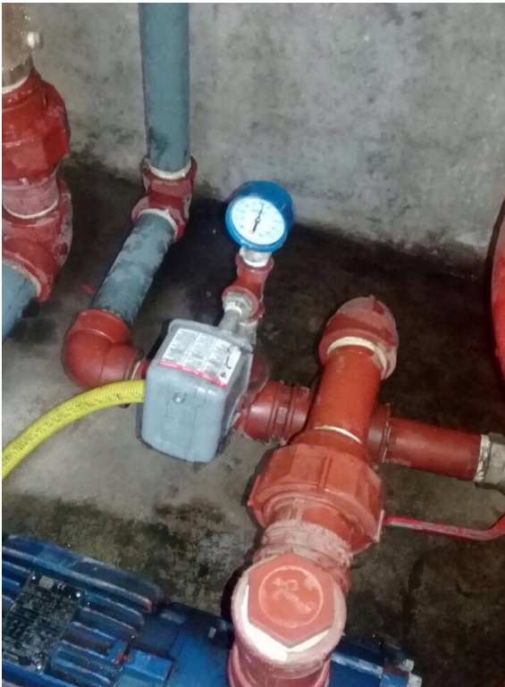
Instalaciones de agua potable y alcantarillado.
