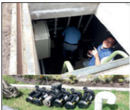
Instalaciones de agua potable y alcantarillado
